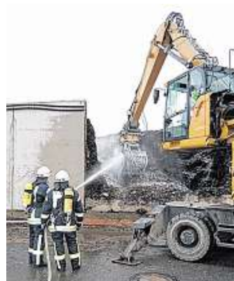
Mit Hilfe eines Baggers war eine Mauer eingerissen worden, um besser löschen zu können.
